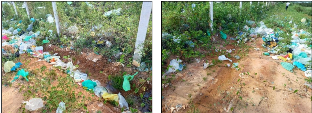
Figura 46 – Pontos umedecidos no pé do talude entre a ETE e o aterro sanitário
