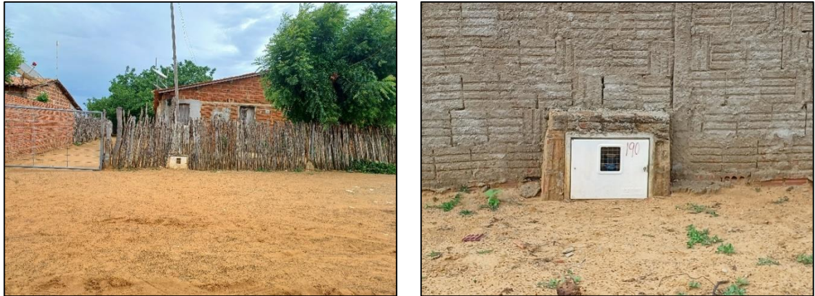
Figura 21 – Residências com hidrômetro na comunidade de Palheiros III
