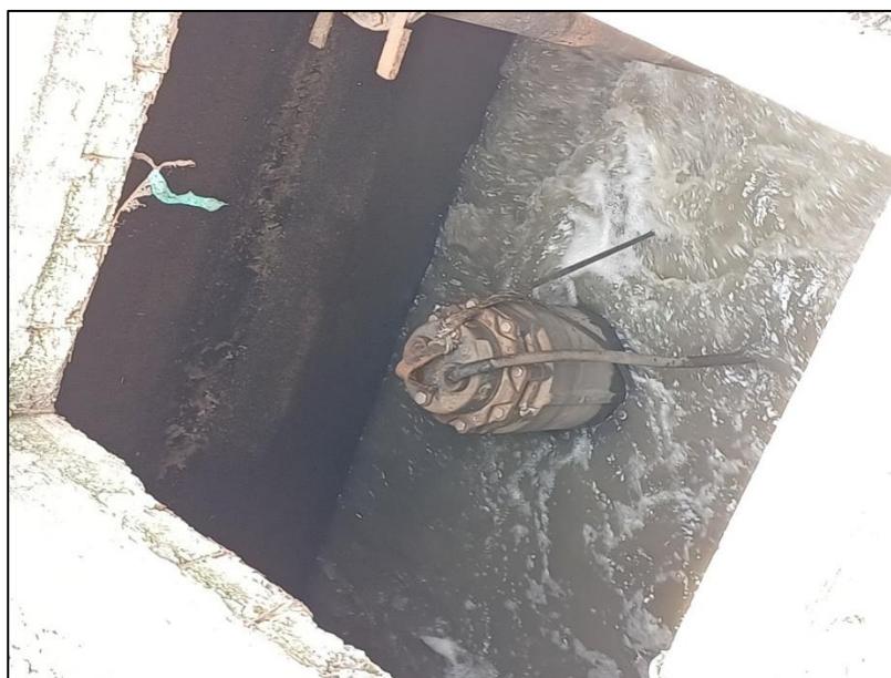
Figura 42 – Bomba em bom estado de conservação, todavia operando com nível de esgoto no poço abaixo do recomendado
