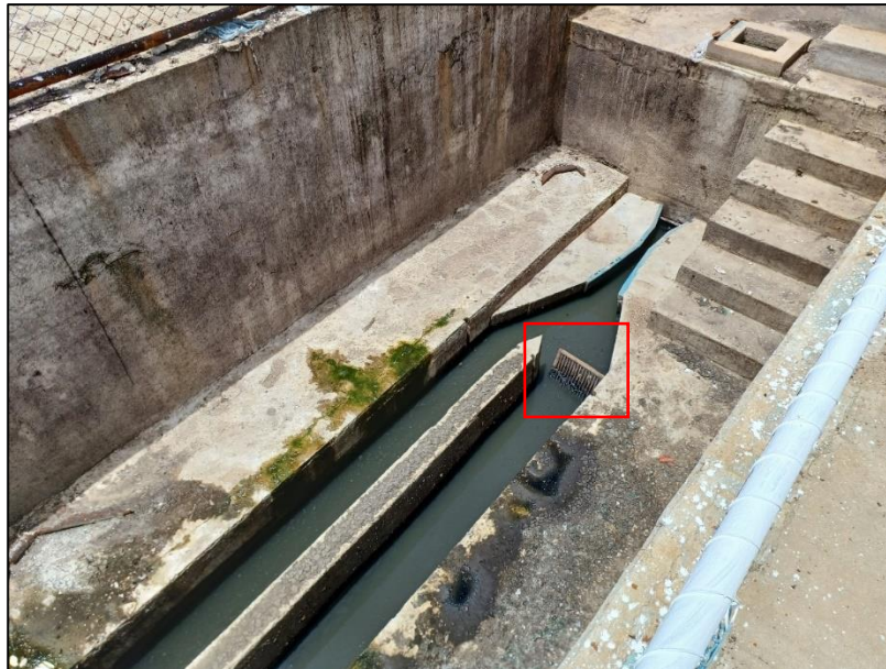
Figura 36 – Grade mal posicionada e calha Parshall afogada
