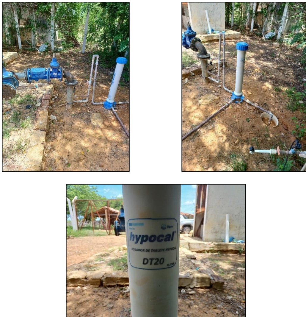
Figura 10 – Clorador instalado na saída do Poço 2
