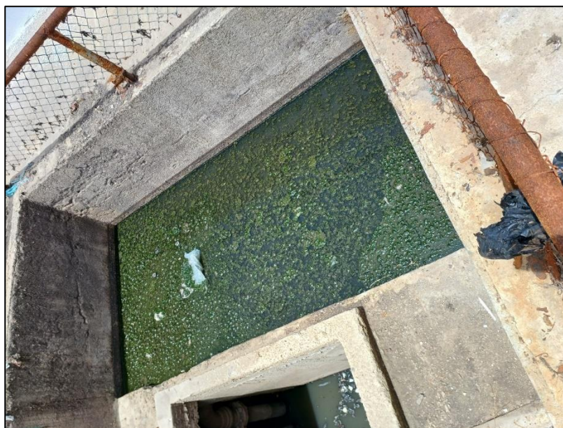
Figura 37 – Barrilete com acúmulo de água de chuva e esgoto devido ao entupimento da tubulação, e também com a presença de resíduos sólidos
