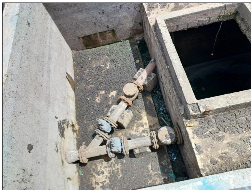
Figura 41 – Barrilete com lodo acumulado no fundo e tubulação de recalque com princípio de oxidação
