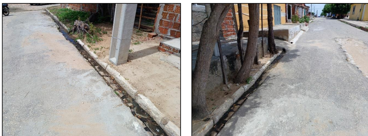
Figura 26 – Esgoto a céu aberto nas ruas de Upanema/RN
