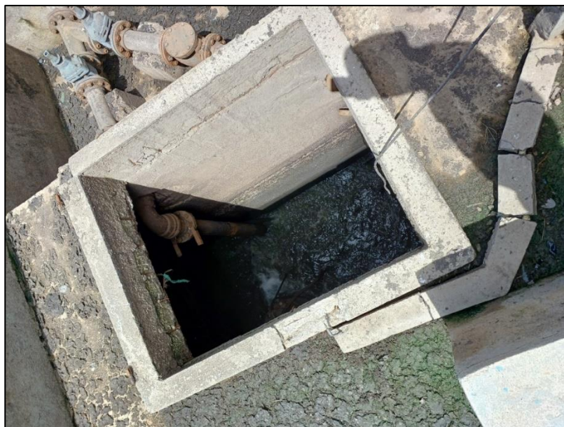
Figura 40 – Poço de sucção com lodo acumulado no fundo e tubulação apresentando princípio de corrosão
