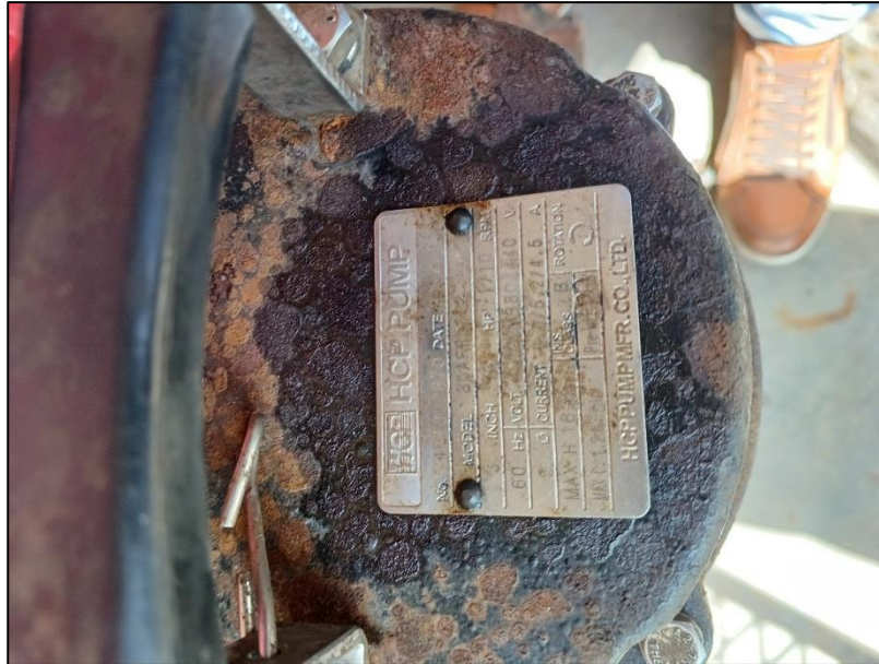
Figura 30 – Bomba reserva com sinais de corrosão
