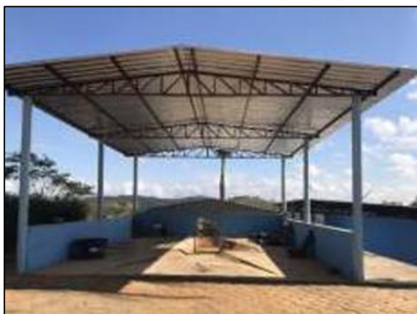
Figura 77 – Recepção de usina de triagem e fosso de descarga
